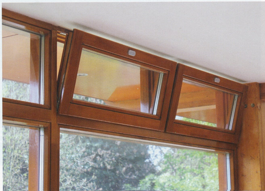
Elektrisch bedienbare klepramen in een nulwoning.
